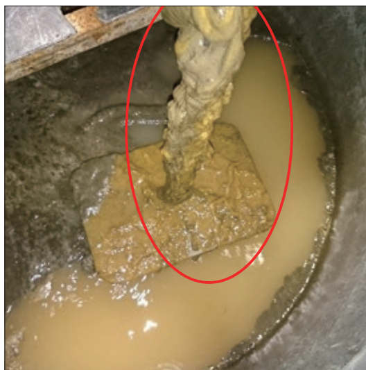
図4 処理中に発生した泥状油
