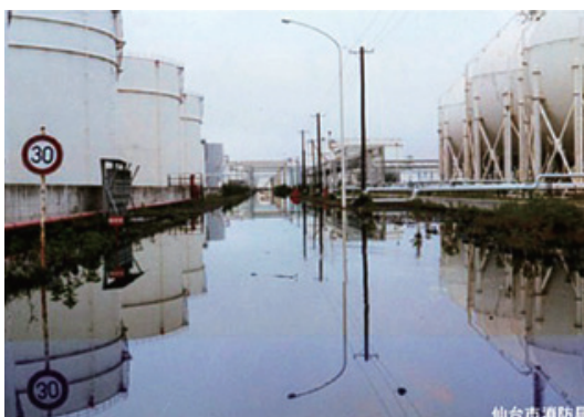
写真1 タンクのアニュラー部破断により構内に流出した油
